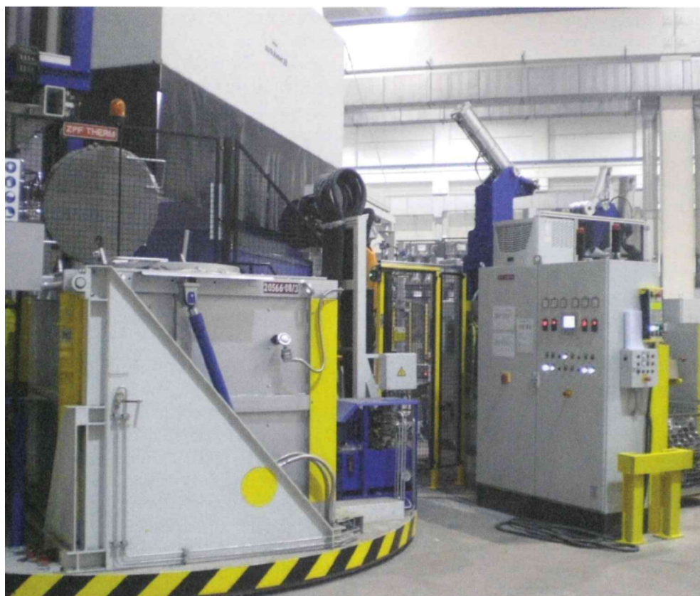
Рис. 5. Гибкость снабжения МЛД расплавом обеспечивается двумя тигельными раздаточными печами установленными на поворотном столе.
