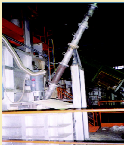
Система перемещения металла на литейном заводе, с применением транспортировочного насоса Metaullics и соответствующих труб.
